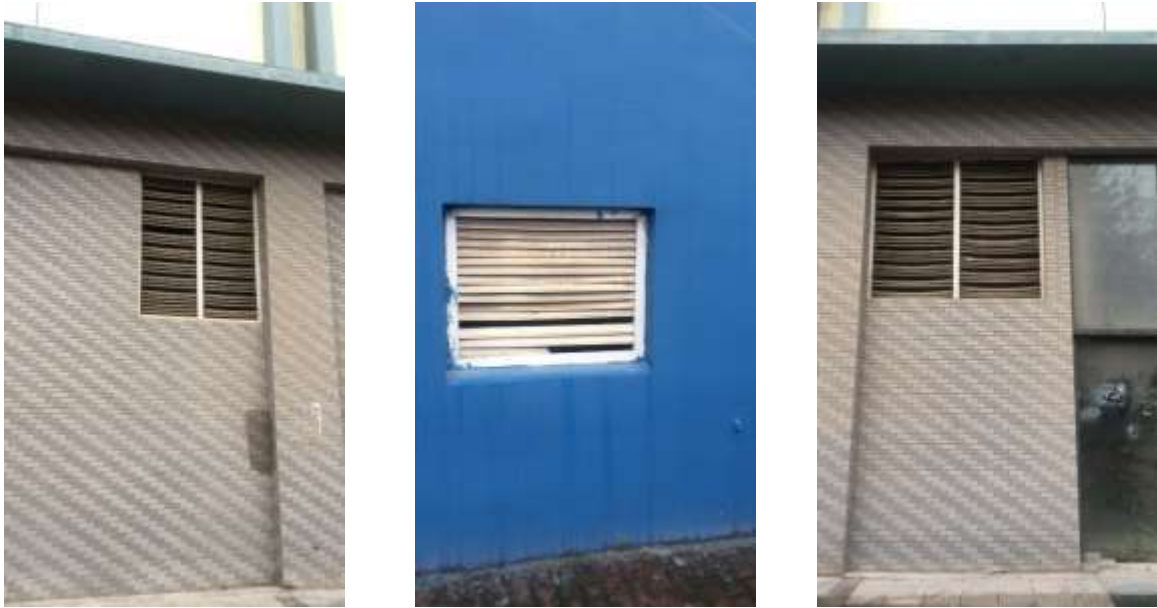
地下车库出风口
